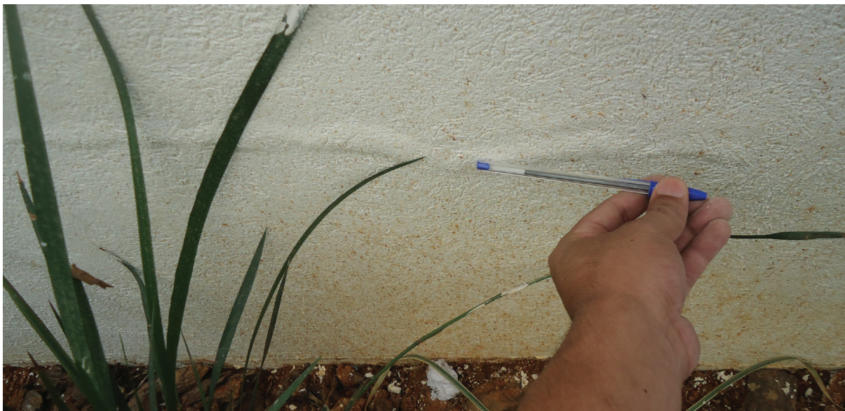
Figura 4 - Bolhas no revestimento na região do jardim devido ao excesso de umidade do solo. Fonte: elaborado pelos autores.
