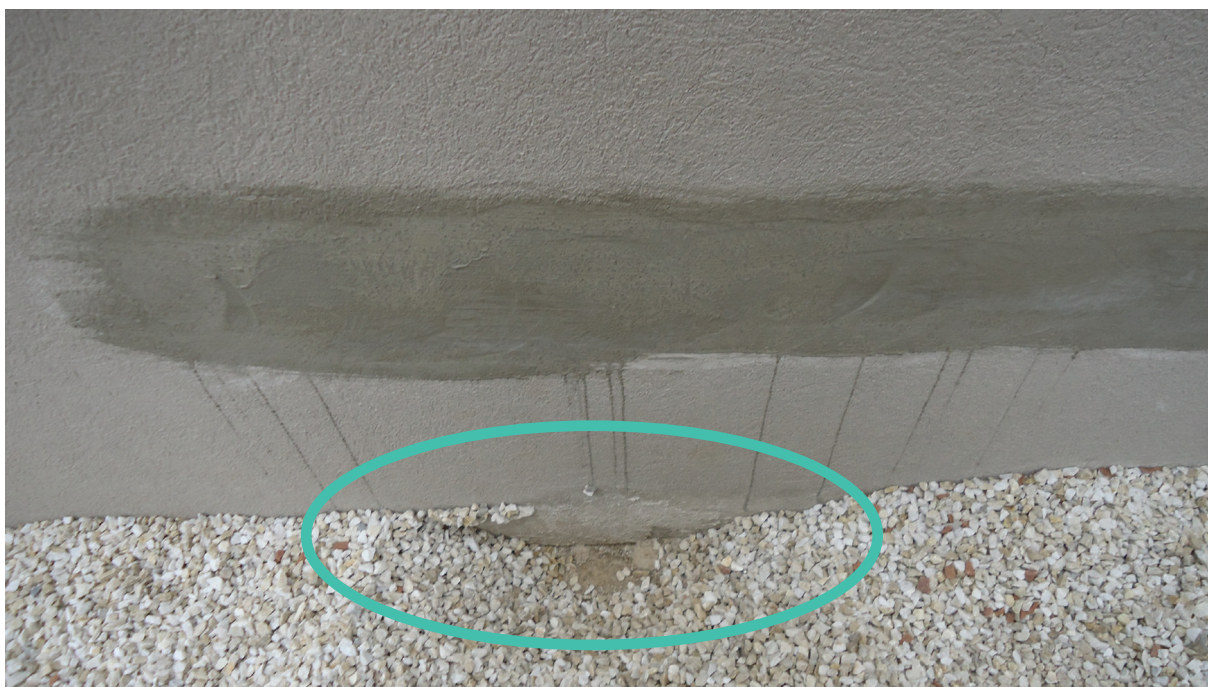
Figura 3 – Região da Figura 2. Contato do sistema de revestimento com o pedrisco que apresentava umidade excessiva. Fonte: elaborado pelos autores.
