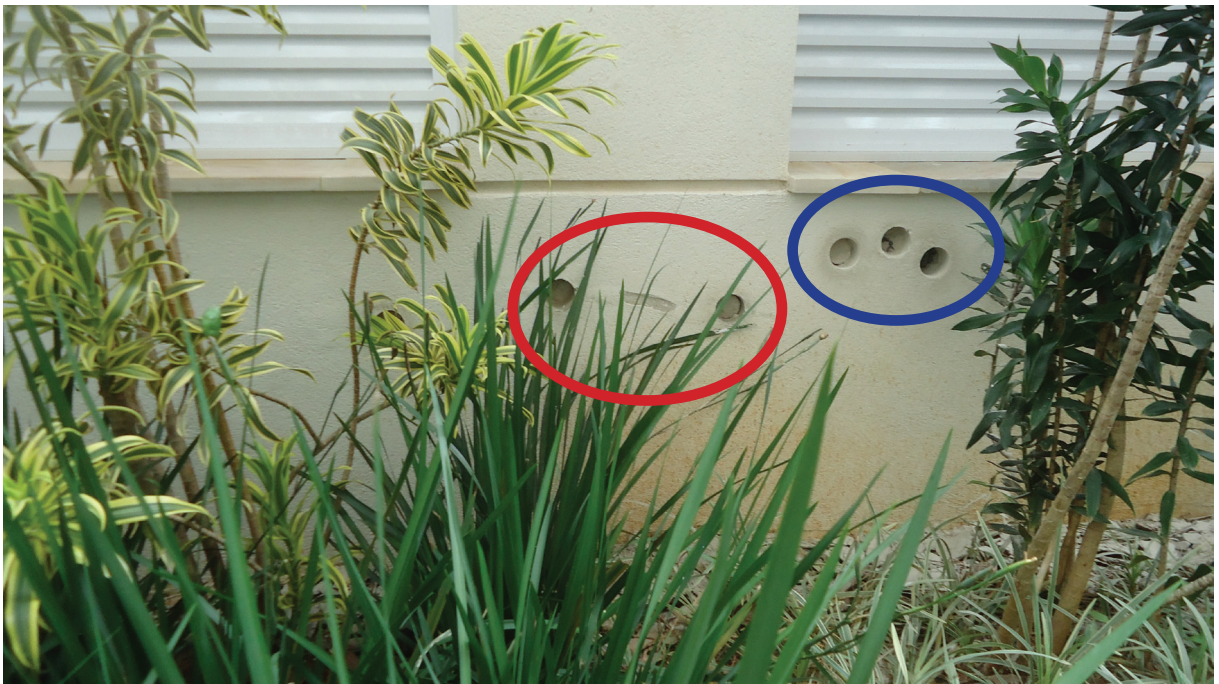
Figura 6 – Em vermelho, região com presença de bolhas (estufamento) e, em azul, região sem anomalia. Em laboratório, foi determinado o teor de umidade do emboço dessas amostras. Ensaio E10. Fonte: elaborado pelos autores.
