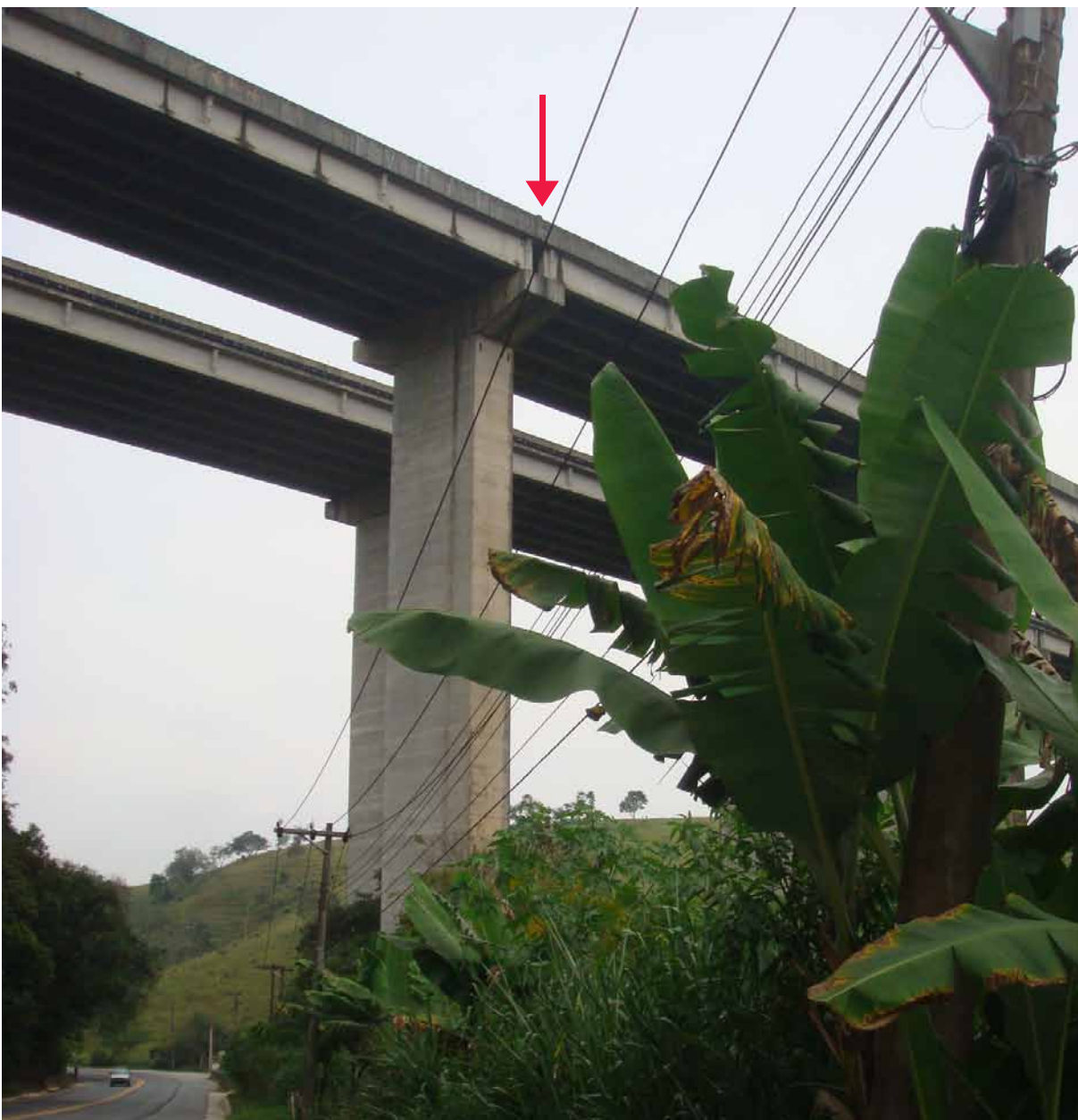
Figura 17 – Viaduto com altura de aproximadamente de 60 metros. A seta indica o local da junta de dilatação, mostrando a inexistência de plataforma para inspeção e manutenção.
