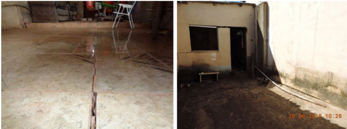
Figura 6 – Abertura de trincas em pisos e alvenarias
