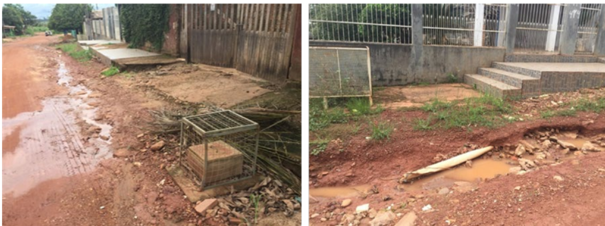
Figura 7 – Erosões em vias de acesso às edificações
