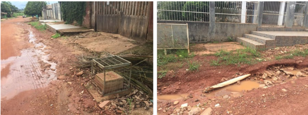
Figura 7 – Erosões em vias de acesso às edificações
