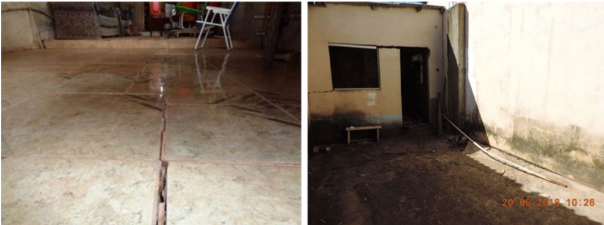
Figura 6 – Abertura de trincas em pisos e alvenarias
