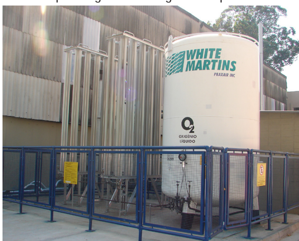
Tanque criogênico de oxigênio e vaporizador
