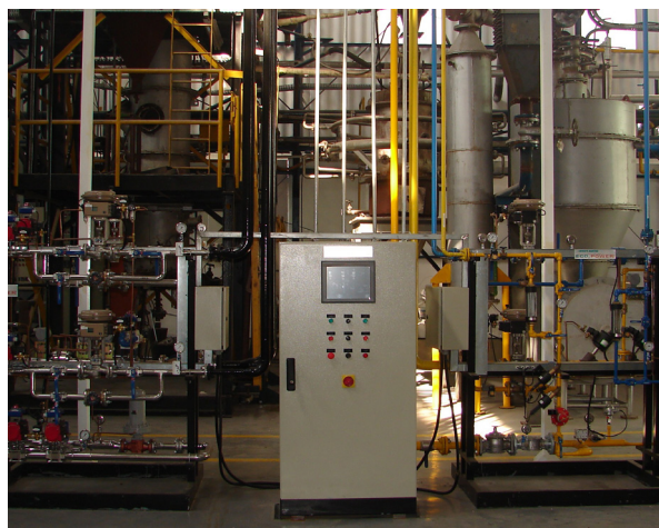
Painel de controle das fornalhas
