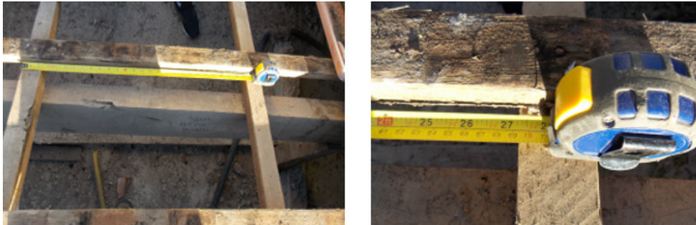
Figura 12 - Irregularidade no espaçamento entre caibros de 69,50cm em desconformidade com o projeto
