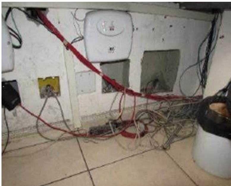
Fotografia 8 : Evidencia deterioração dos elementos da portaria condominial, associada à ausência ou insuficiência de manutenção preventiva ao longo do período de uso da edificação.
