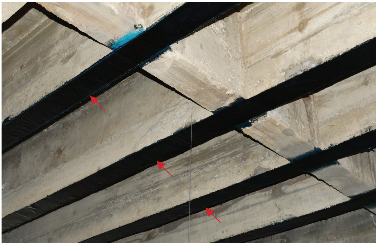
Figura 1 – Técnica EBR . Laminados de PRFC (setas) colados na superfície da região tracionada das vigas. Fonte: elaboração própria.
