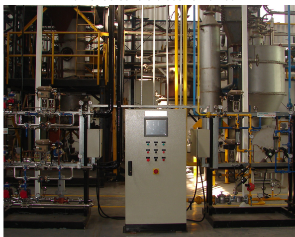
Painel de controle das fornalhas
