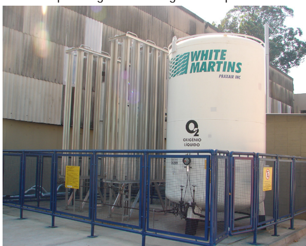
Tanque criogênico de oxigênio e vaporizador
