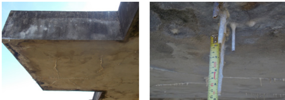
Figura 11 - Marquise com infiltrações, lixiviações e eflorescências com formação de estalactites
