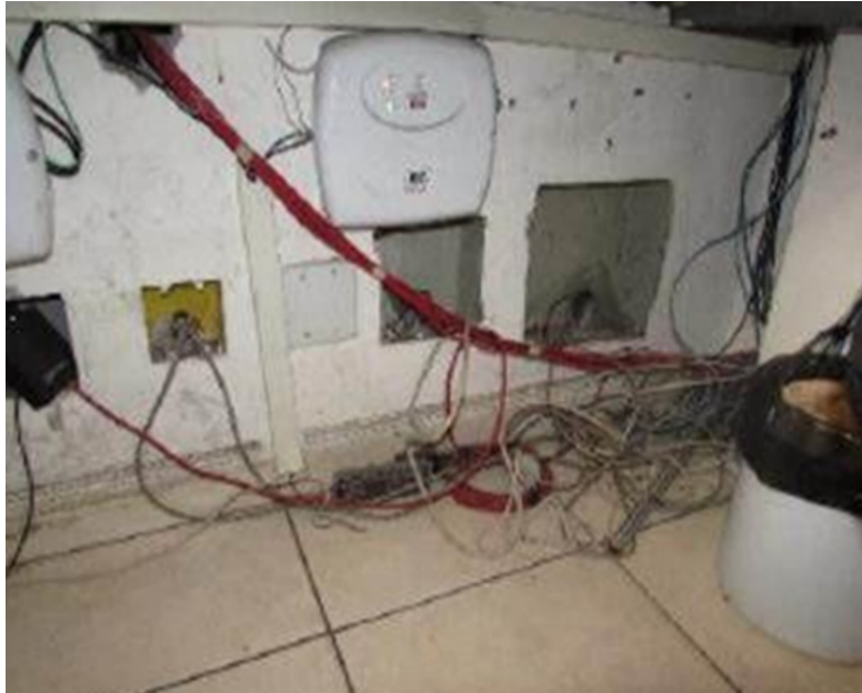
Fotografia 8 : Evidência deterioração dos elementos da portaria condominial, associada à ausência ou insuficiência de manutenção preventiva ao longo do período de uso da edificação.
