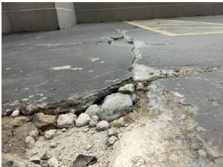
Fotografia 2: Deterioração precoce do piso de proteção da impermeabilização do estacionamento em decorrência da ausência de projeto específico para sua execução.
