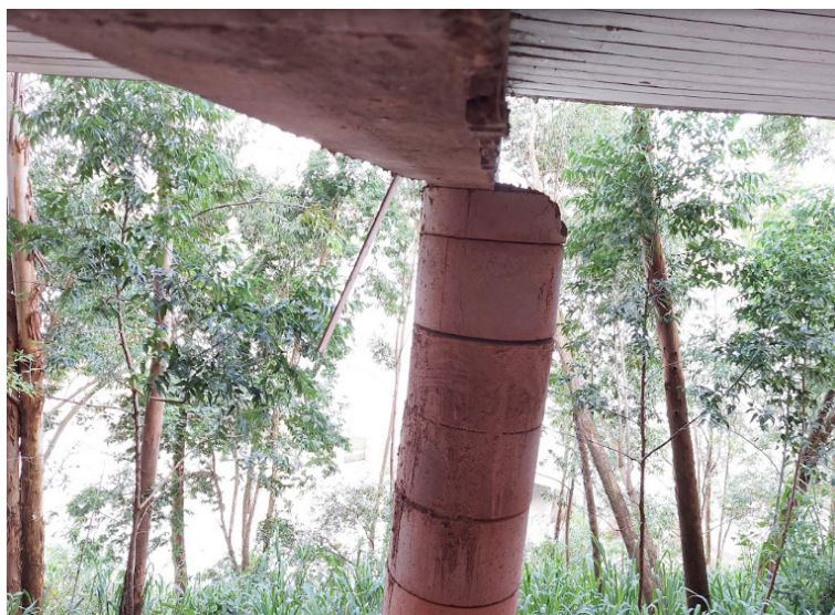
Fotografia 4: Patologia estrutural associada ao desaprumo do elemento em razão de inadequação na locação da estaca.
