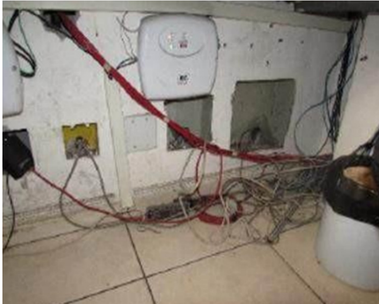
Fotografia 8 : Evidência deterioração dos elementos da portaria condominial, associada à ausência ou insuficiência de manutenção preventiva ao longo do período de uso da edificação.
