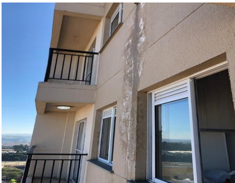
Fotografia 6: Vazamento na fachada decorrente de intervenção realizada pelo proprietário na tubulação do medidor de água durante reforma da unidade.
