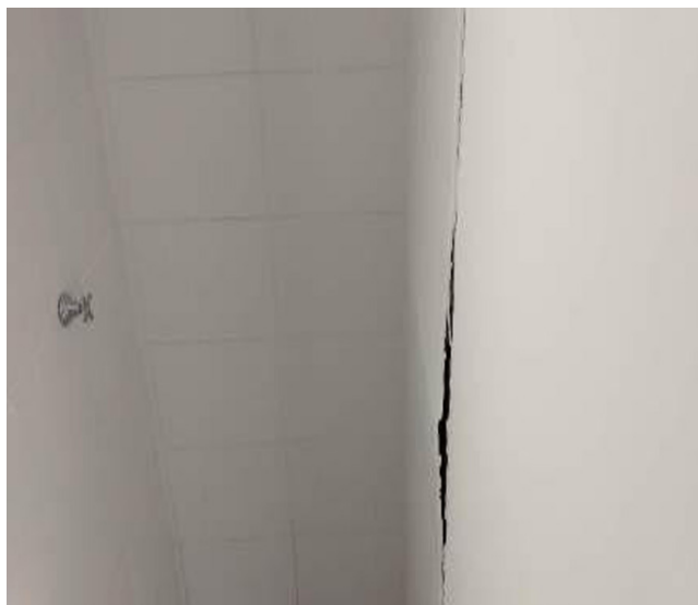
Fotografia 3: Ocorrência de destacamento prematuro do revestimento cerâmico em unidade recém-entregue
