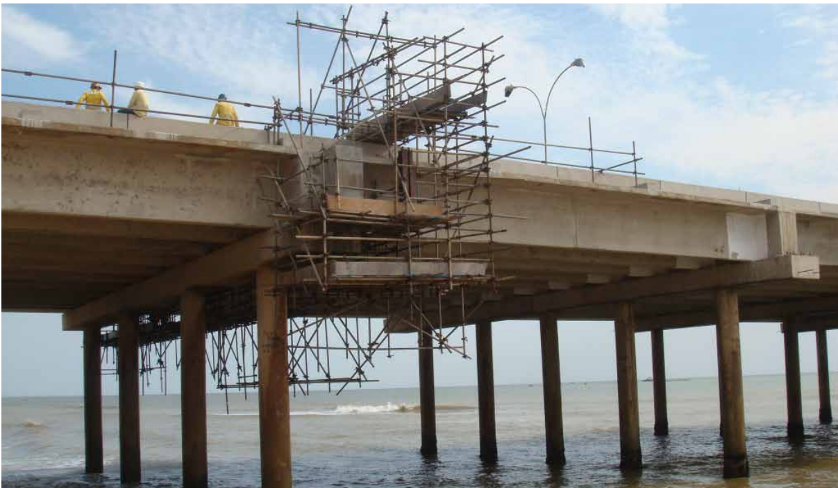
Figura 8 – Sistema de plataforma provisório para realização de atividades de manutenção. Fonte: elaboração própria.
