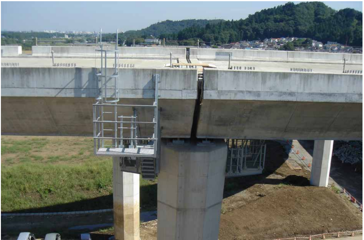
Figura 16 – Detalhe da plataforma instalada na região de junta, indicada na seta 1 da Figura 15. Note-se que as plataformas estão instaladas em ambos os lados. Fonte: elaboração própria.
