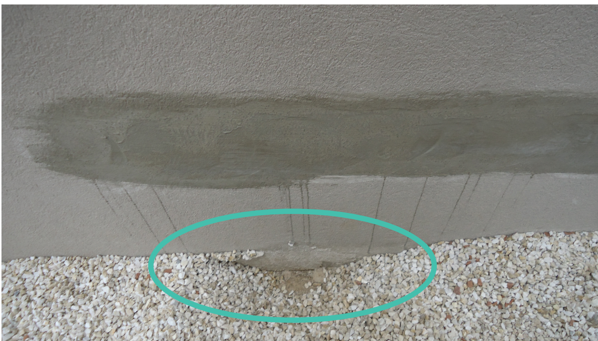
Figura 3 – Região da Figura 2. Contato do sistema de revestimento com o pedrisco que apresentava umidade excessiva. Fonte: elaborado pelos autores.
