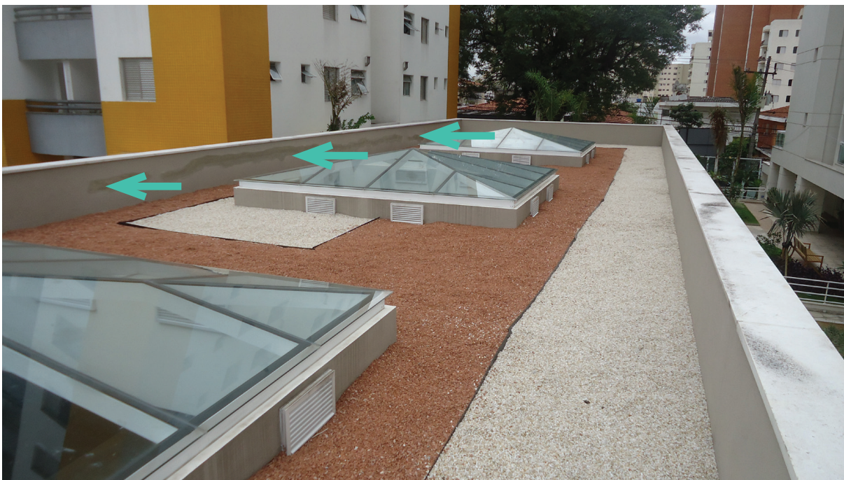
Figura 2 – Vista do teto da piscina. As setas indicam regiões do revestimento em processo de recuperação. Fonte: elaborado pelos autores.
